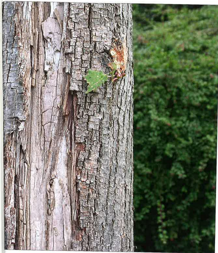
Spalte eines Stammrisses.
